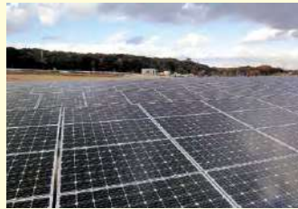
住民参加型くにうみ太陽光発電所(1MW)
