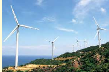
南あわじ市阿那賀地区(2,500kw×15基)
