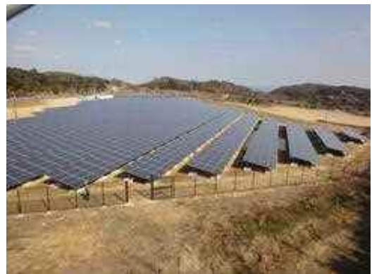
住民参加型太陽光発電所
