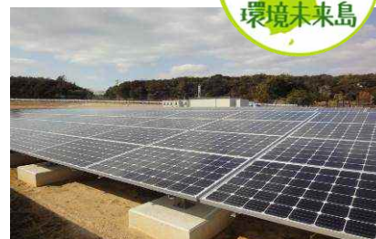
住民参加型くにうみ太陽光発電所
