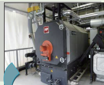
【大型竹チップボイラー】
